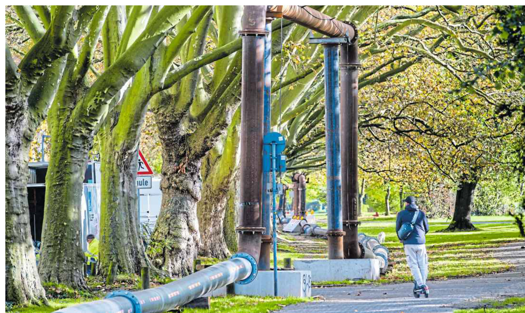
Über diese Rohrleitung unter den Platanen an der Ravensberger Straße wird das Lutterkanalwasser während der aktuellen Kanal-Bauarbeiten geleitet.
